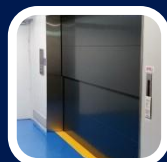
貨物用エレベーター
