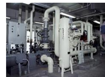
ビルの空調設備
