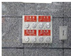
消火栓送水口
